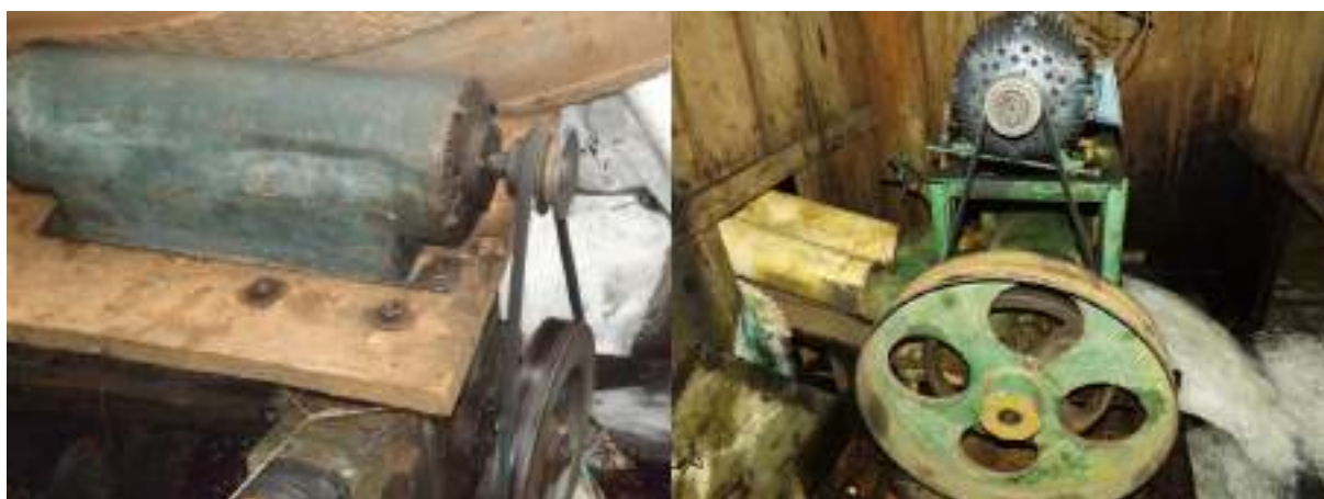
Figura 25 - Geradores movidos à água
